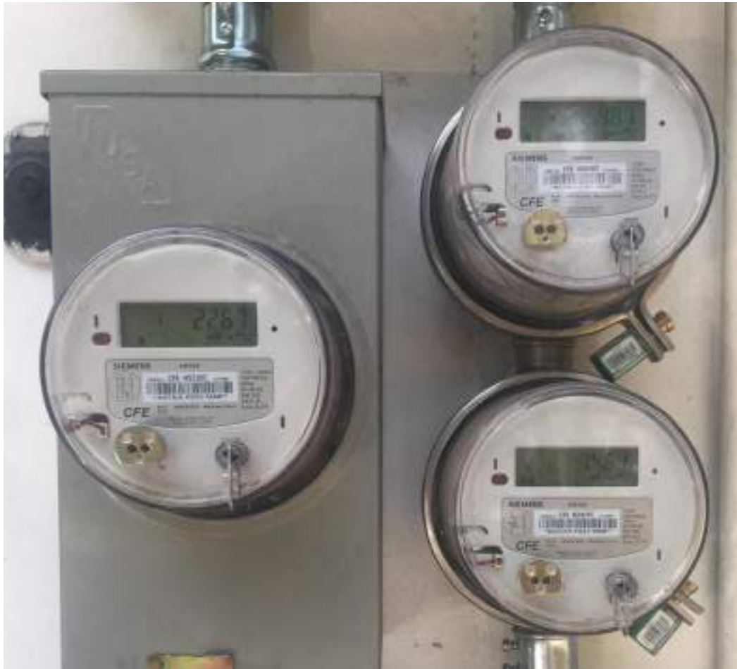
Medidores AMI de CFE
