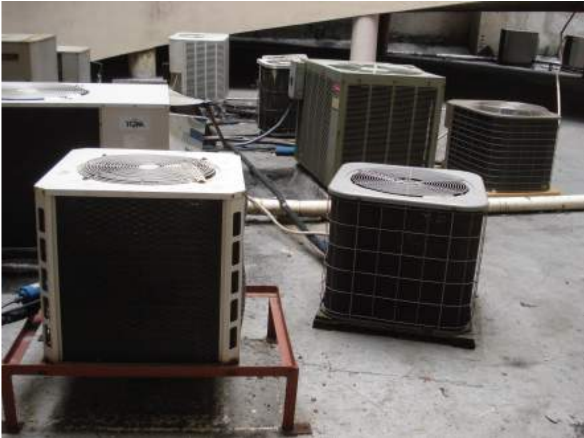
Condensadores de equipos de AC en Santo Domingo, República Dominicana.
