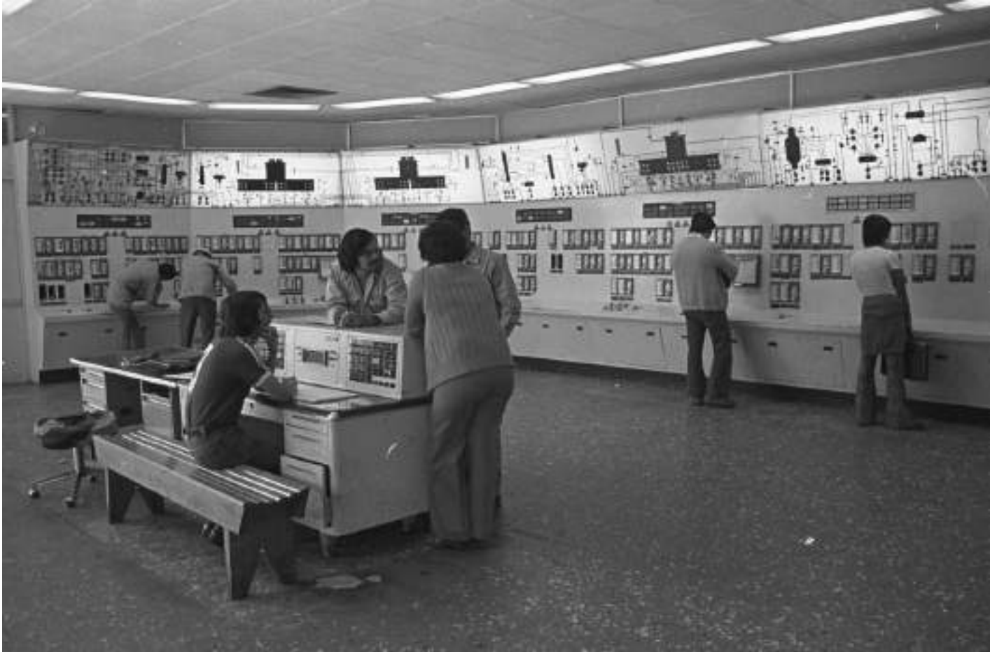
Cuarto de control en Refinería de Tula.
